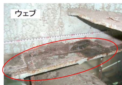
横桁補修部(損傷部のウェブ側に疲労き裂)
