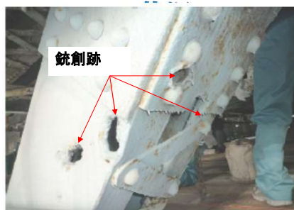
トラス斜材の銹創跡
