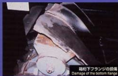
損傷した箱桁の内部 Inside of the damaged box girder
