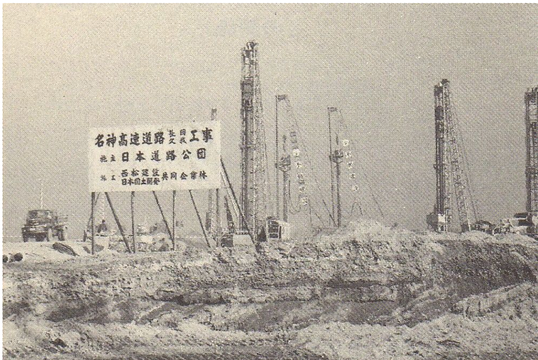
「名神高速道路」 おとくに 乙訓地区 サンドドレーン工事 (出典②) ( じぼん やわらかい地盤から水をすいとりに固くした)
